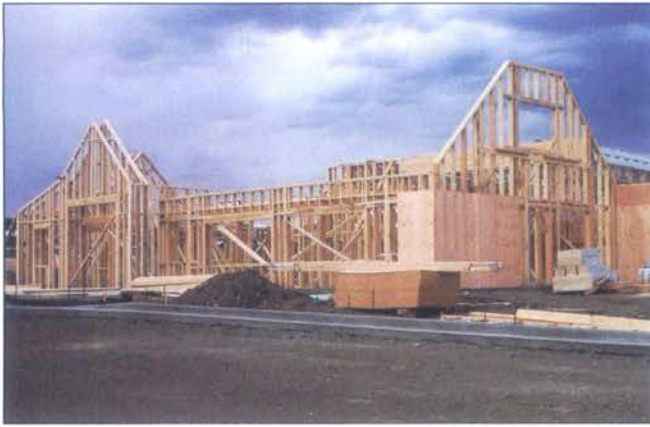
Imagen 4.59 La madera expuesta en esta construcción contribuiría a la rápida propagación del fuego.
