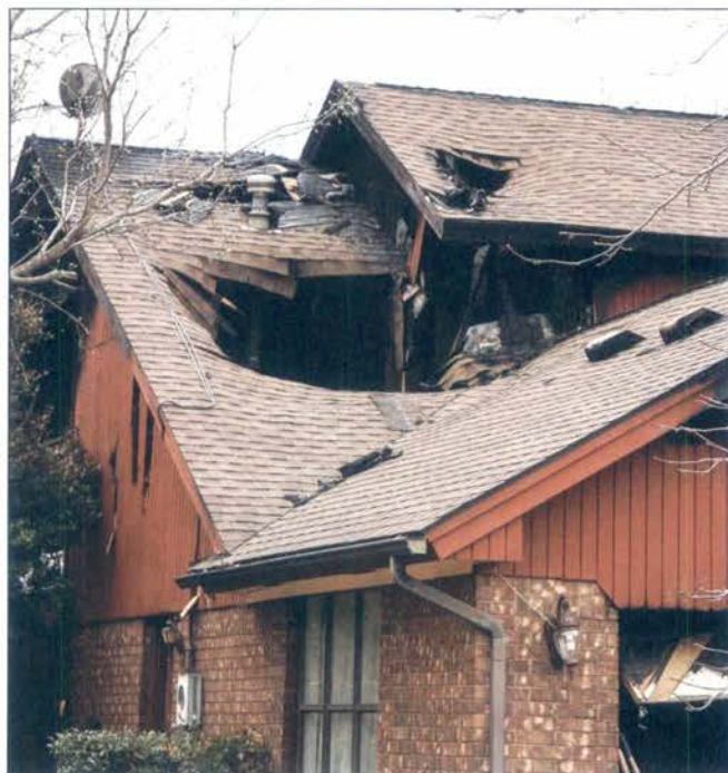
Imagen 4.57 Partes del techo de esta casa moderna fallaron durante un incendio y cayeron dentro de la edificación.
