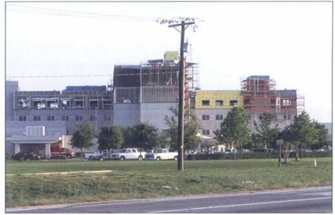
Imagen 4.60 Durante la renovación de este hospital podría surgir una serie de situaciones peligrosas que contribuirían a la propagación del fuego. Cortesía de Ron Moore, McKinney (TX) FD.
