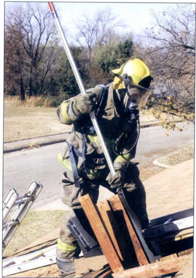
Imagen 11.28 Un bombero usa una pértiga para abrir el techo debajo de una abertura de ventilación.
