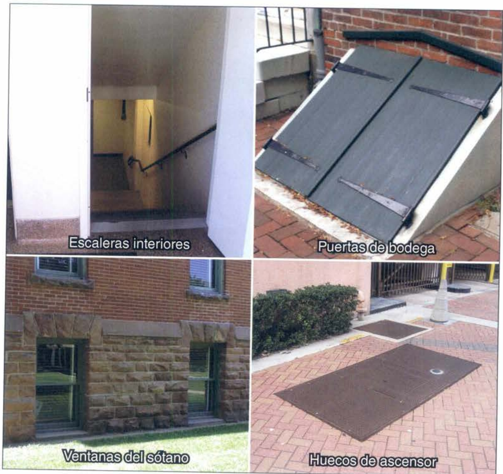
Imagen 11.36 Ejemplos de puntos de acceso al sótano.
