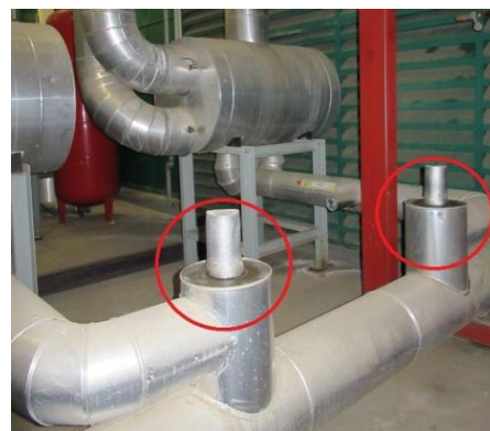
Detalle de dos válvulas de amoníaco líquido a la entrada de los evaporadores Foto. C.Artero
