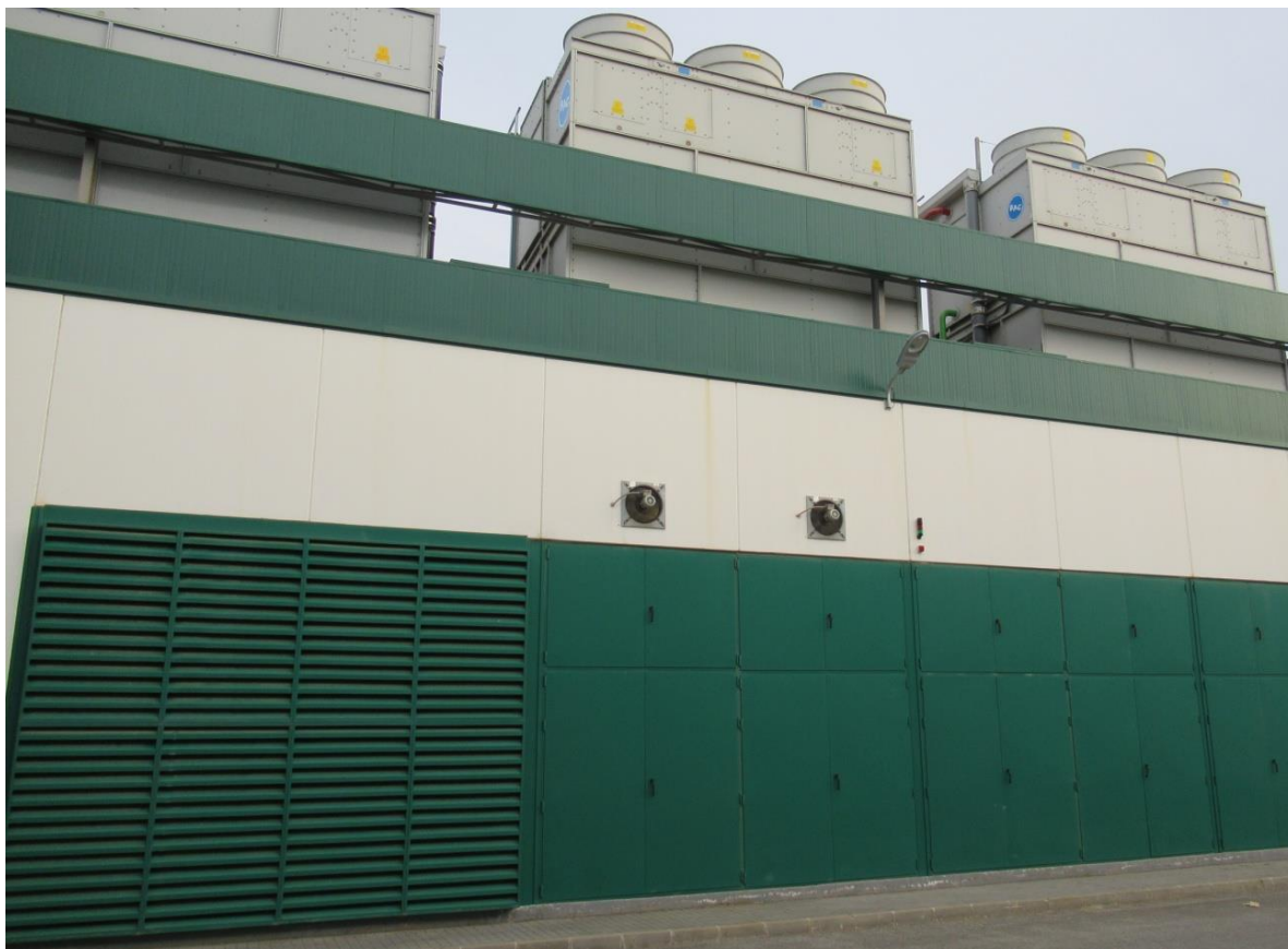
Vista lateral de una sala de máquinas. Se observan las rejillas para la ventilación natural y dos ventiladores para la ventilación forzada. Y arriba tres condensadores evaporativos. Foto: C. Artero
