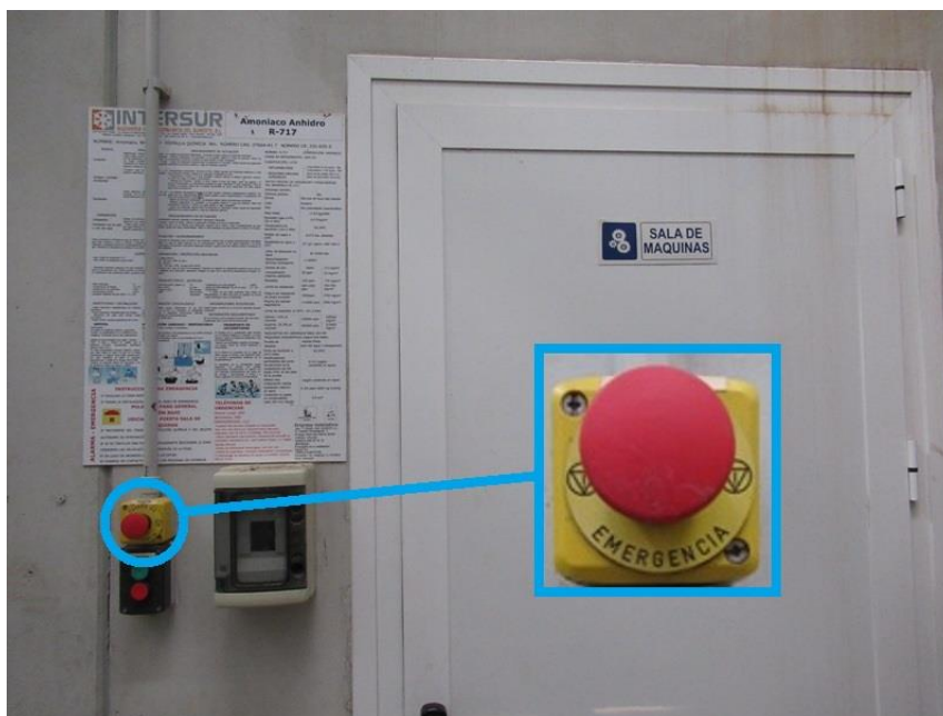
Pulsador de emergencia fuera de la sala de máquinas que para todo el sistema de refrigeración. Foto: C. Artero
