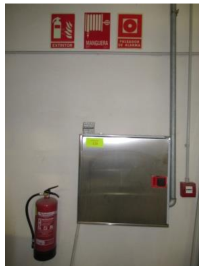
Medios de PCI en el interior de la sala de máquinas. Foto: C. Artero
