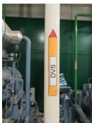
Identificación de una tubería de descarga de una válvula de seguridad. Foto. C.Artero
