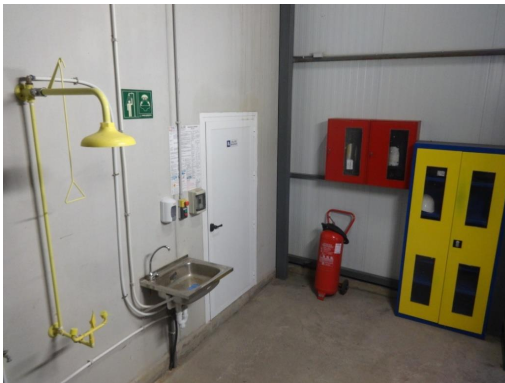
Zona de entrada a la sala de máquinas Foto. C.Artero
