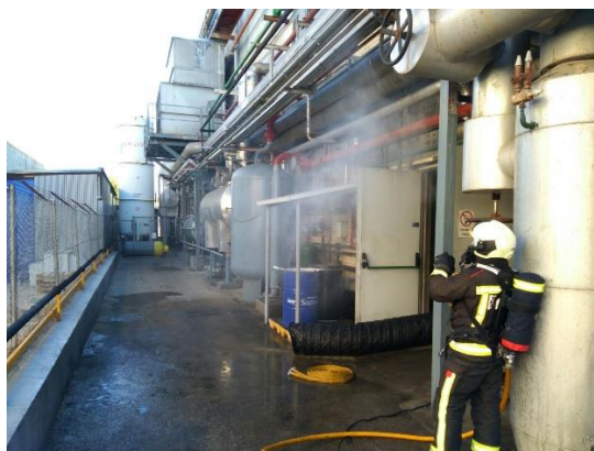
Pulverización de agua en fuga de amoníaco Fuente: M.Albaladejo
