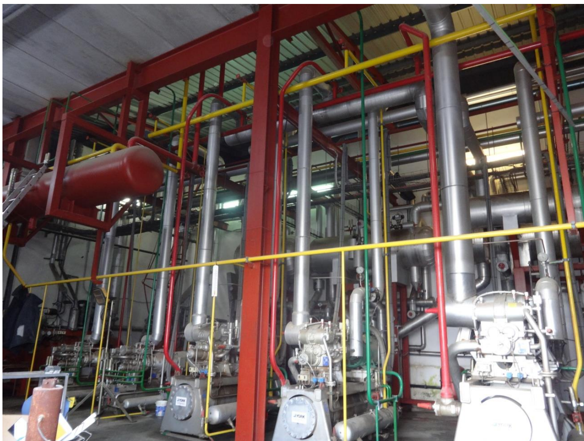
Sala de máquinas con cinco circuitos de refrigeración para cinco zonas con diferentes temperaturas. Foto: C. Artero
