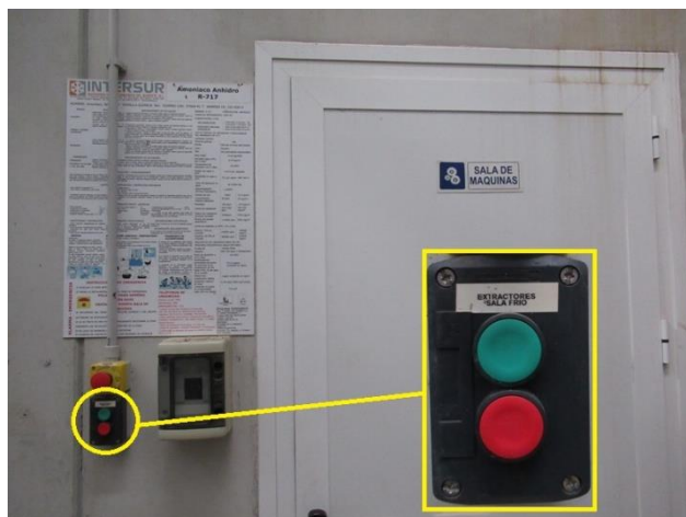
Botones de arranque y parada de la ventilación forzada en el exterior de la sala. Foto: C. Artero
